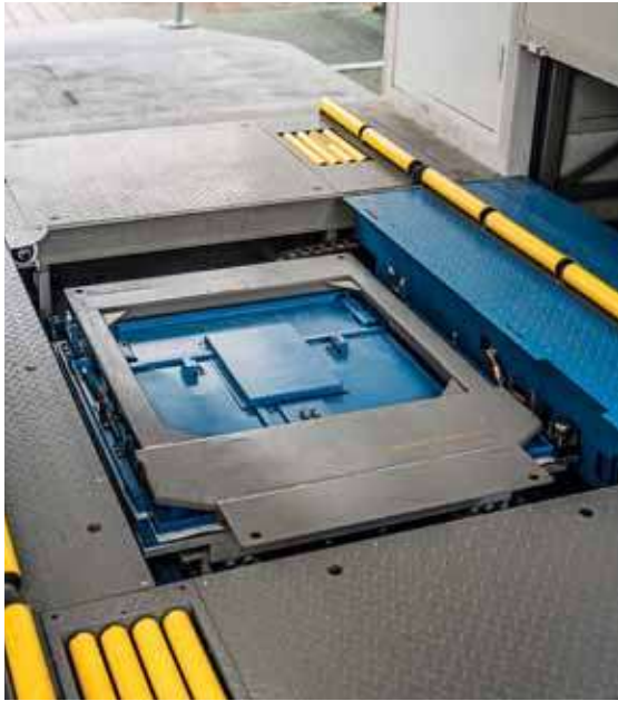
Batteriewechselanlage in Berlin: Ein Roboter löst den Akku, von der Seite surrt ein voller Akku heran und wird mit dem Auto verschraubt.
